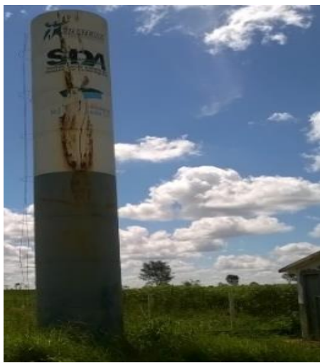
FIGURA 61: RESERVATÓRIO DO ASSENTAMENTO RURAL VICENTE DE PAULA.
