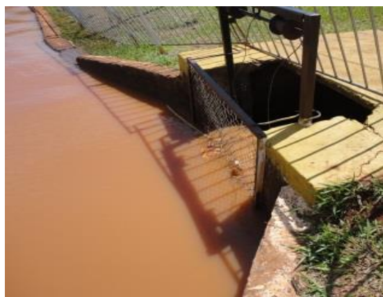
FIGURA 34: VERTEDOR DO LAGO NO PONTO DRE 02.
