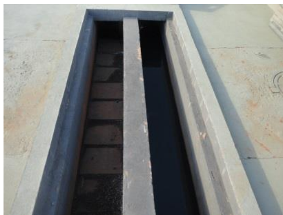
FIGURA 21: CAIXA DE AREIA NO PONTO ESG 01.
