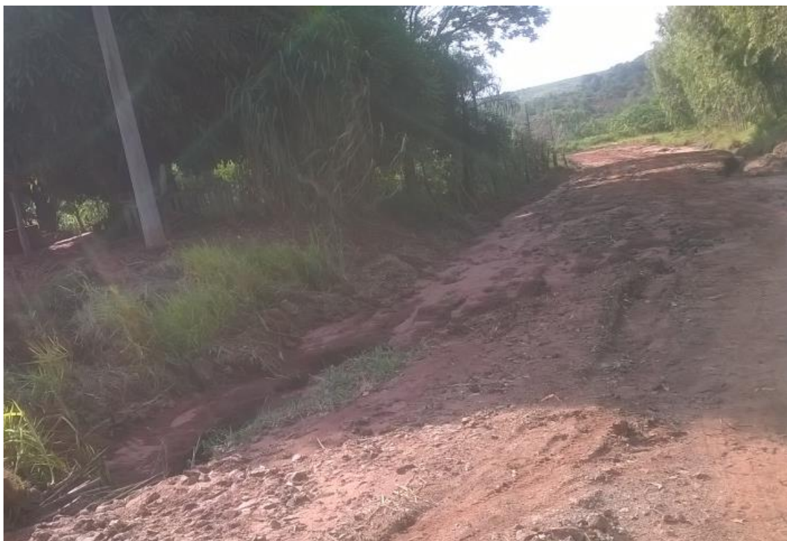
FIGURA 67: DETALHE DA RUA SEM PAVIMENTAÇÃO SUJEITA A EROÇÃO.
