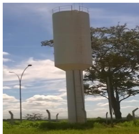
FIGURA 49: RESERVATÓRIO DA ALDEIA INDÍGENA PARAGUASSÚ.
