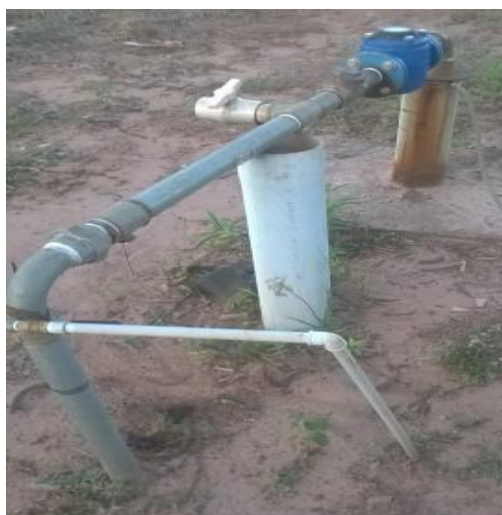
FIGURA 60: POÇO ARTESIANO DA ALDEIA INDÍGENA PROTERO GUAÇU.
