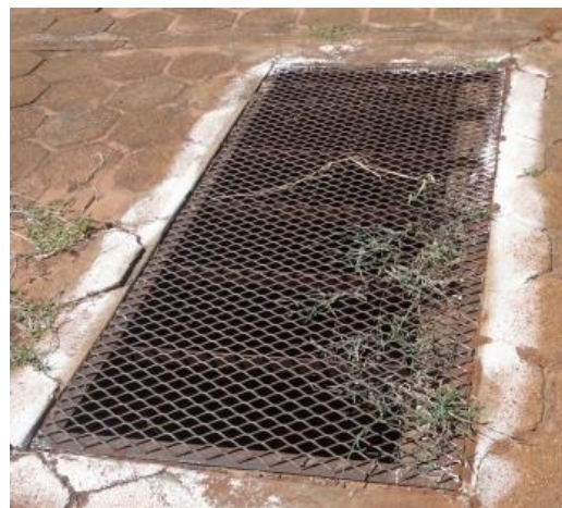
FIGURA 31: RECEPTOR DE ÁGUA DE DRENAGEM URBANA NO PONTO DRE 01.
