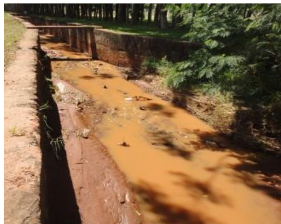
FIGURA 33: CANAL DE DRENAGEM (DETALHE DE ASSOREAMENTO) NO PONTO DRE 02.
