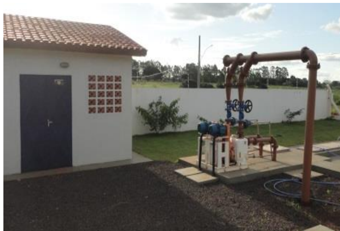
FIGURA 25: ESTAÇÃO ELEVATÓRIA DE ESGOTO NO PONTO ESG 01.
