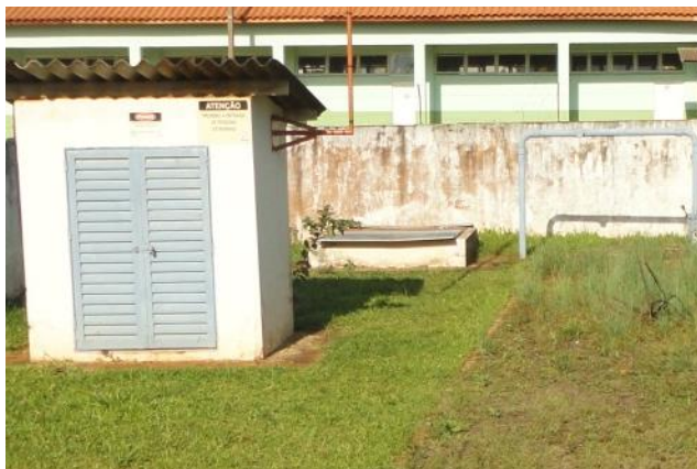
FIGURA 13: POÇO ARTESIANO NO PONTO AGU 02.
