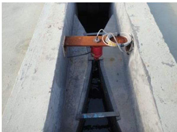
FIGURA 22: CALHA PARSHALL NO PONTO ESG 01.
