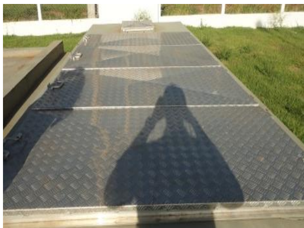
FIGURA 24: TANQUES DE RECEPÇÃO DE ESGOTO DO CAMINHÃO “LIMPA FOSSA” NO PONTO ESG 01.
