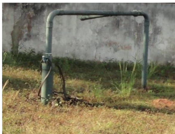
FIGURA 14: POÇO ARTESIANO NO PONTO AGU 01.
