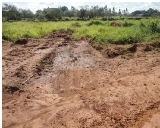
FIGURA 35: SOLO EXPOSTO COM INÍCIO DE EROSÃO.
