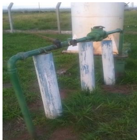
FIGURA 59: POÇO ARTESIANO DA ALDEIA INDÍGENA PROTERO GUAÇU.
