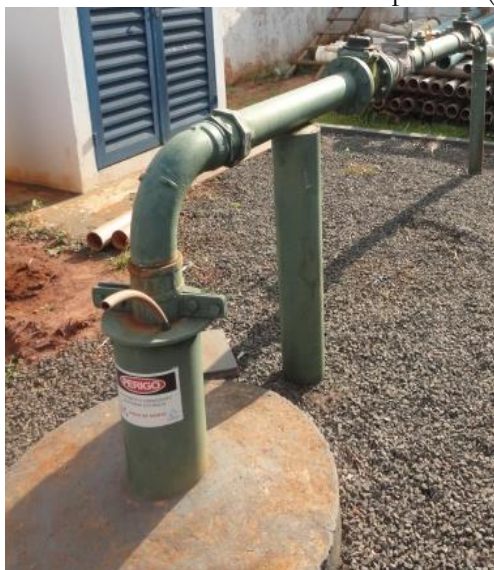
FIGURA 9: POÇO ARTESIANO NO PONTO AGU 01.
