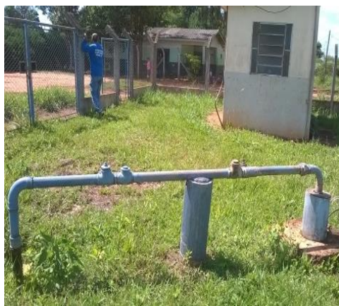
FIGURA 48: POÇO ARTESIANO DA ALDEIA INDÍGENA PARAGUASSÚ.
