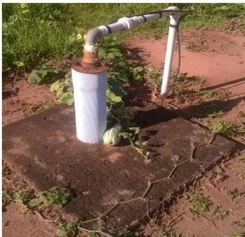
FIGURA 68: POÇO ARTESIANO DO ASSENTAMENTO RURAL SÃO JOSÉ DO JATOBÁ.
