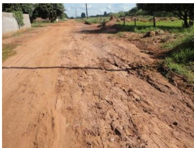
FIGURA 36: SOLO EXPOSTO COM INÍCIO DE EROSÃO.
