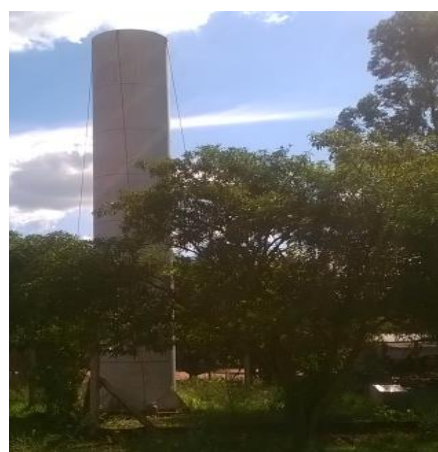
FIGURA 66: RESERVATÓRIO DO DISTRITO DE TAQUAPIRI.
