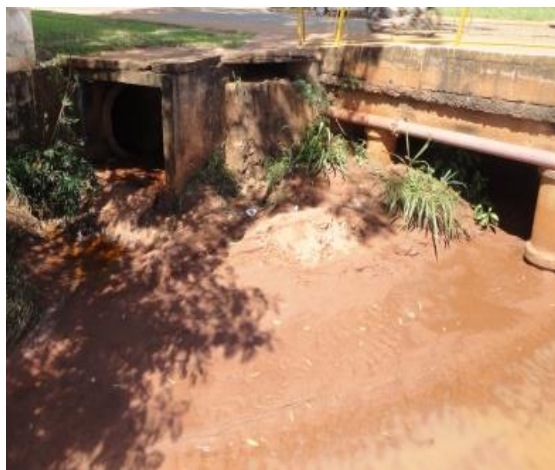
FIGURA 32: CANAL DE DRENAGEM NO PONTO DRE 02.
