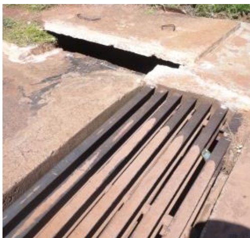
FIGURA 30: “BOCA DE DRAGÃO” AO LADO DA “BOCA DE LOBO” NO PONTO DRE 01.
