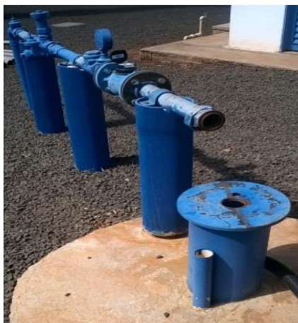
FIGURA 44: POÇO DA ALDEIA ARROIO CORÁ.
