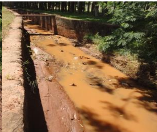
FIGURA 13: CANAL DE DRENAGEM COM PROCESSO DE ASSOREAMENTO.
