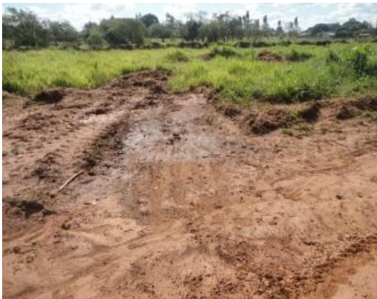
FIGURA 10: SOLO EXPOSTO COM INÍCIO DE EROSÃO.
