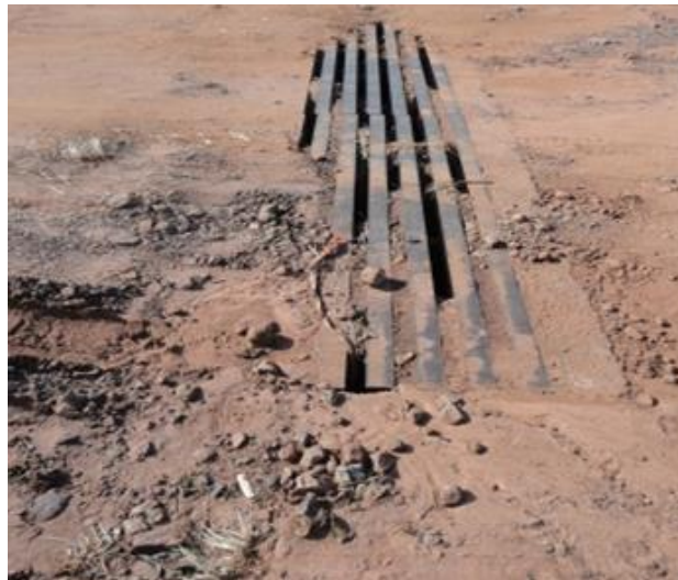
FIGURA 11: BOCA DE DRAGÃO ASSOREADA.
