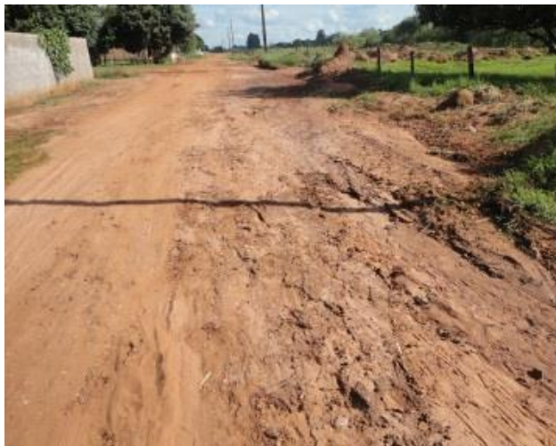
FIGURA 12: SOLO EXPOSTO COM INÍCIO DE EROSÃO.
